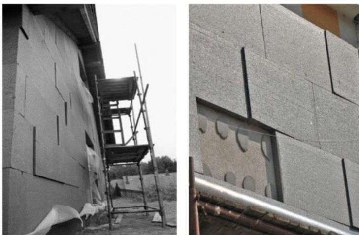
Obrázek 12: Ztráta rozměrové stability grafitových polystyrenových desek při zateplovacích pracích [33]
