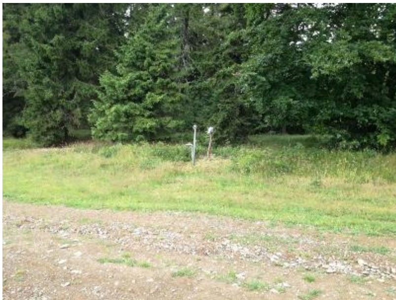
Obrázek 13: Zabudovaný hydrant pro umělé zasněžování na vrcholu sjezdových tratí v Deštném v O. h.
