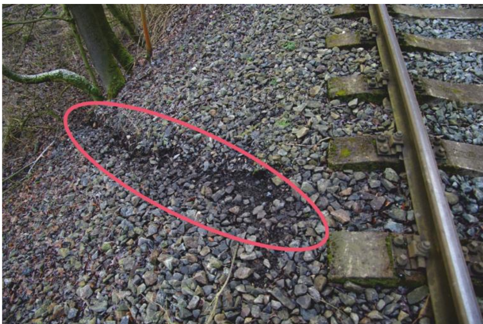
Obr. č. 25: Přejít zvěře přes strmý násep a kolejový svršek. (autor Petr Matějka)
