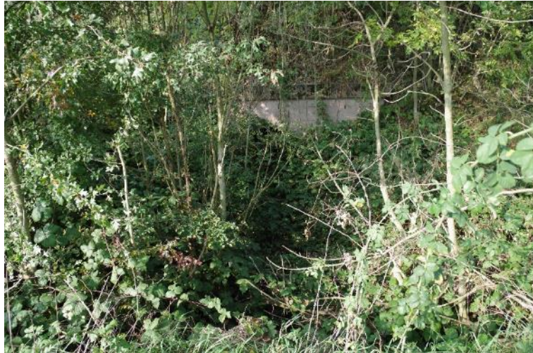
Obr. č. 9: Neudržovaná zeleň před trubním propustkem. (autor Petr Matějka)
