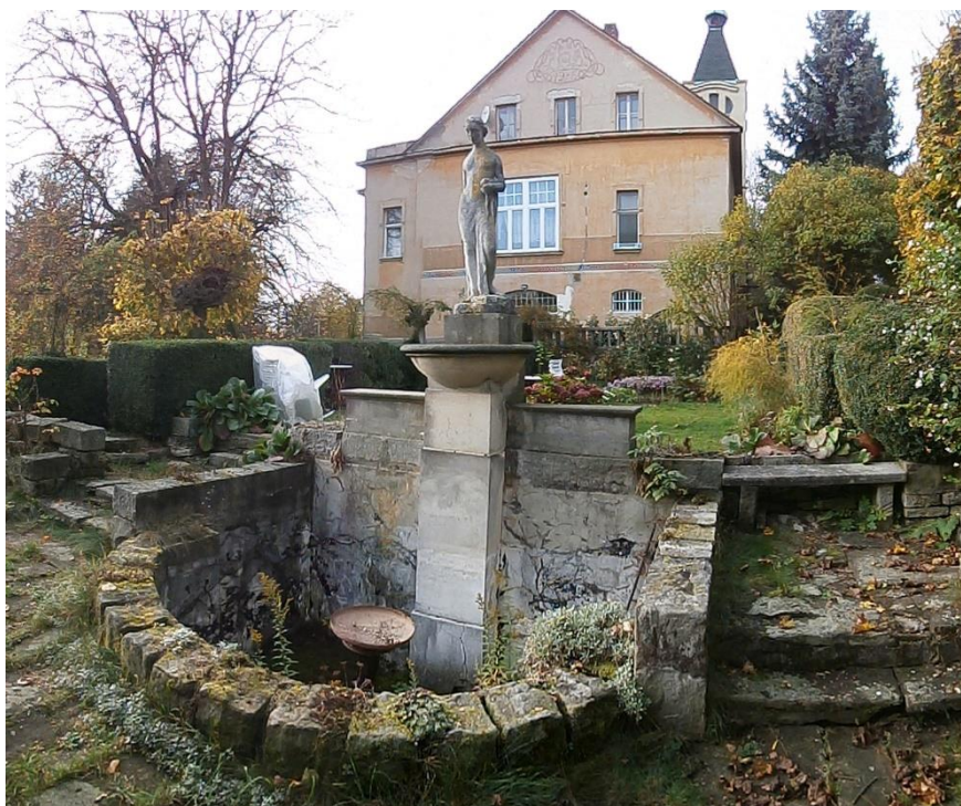
Obrázek 28 – Pohled na zachovalý basin s kašnou a sochou. Basin již není funkční, původní betonová konstrukce popraskala a kašna byla evidentně odmontována. Na fotografii vpravo je vidět odpočívadlo zakomponované do opěrné zdi nad schody vedoucími k travnatému parteru zakončenému pavilonem.
