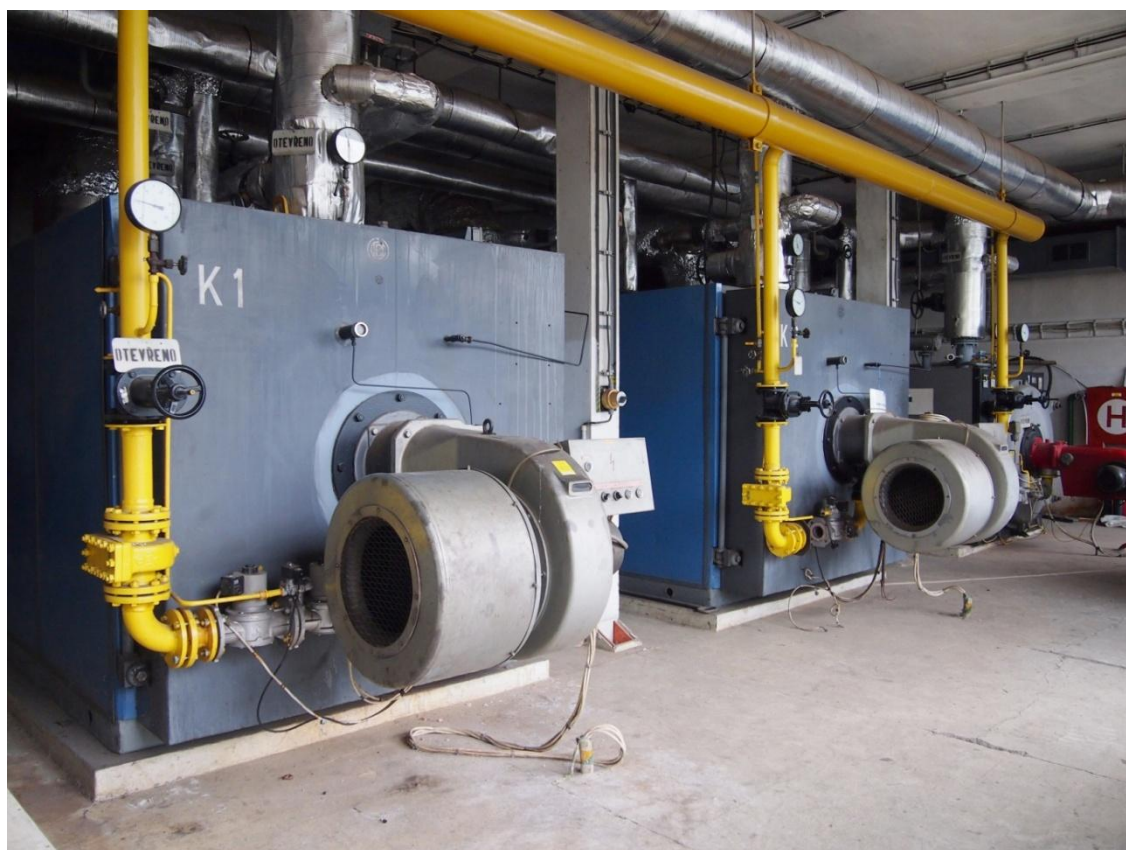
Obr. 6 Současná kotelna objektu [25]
