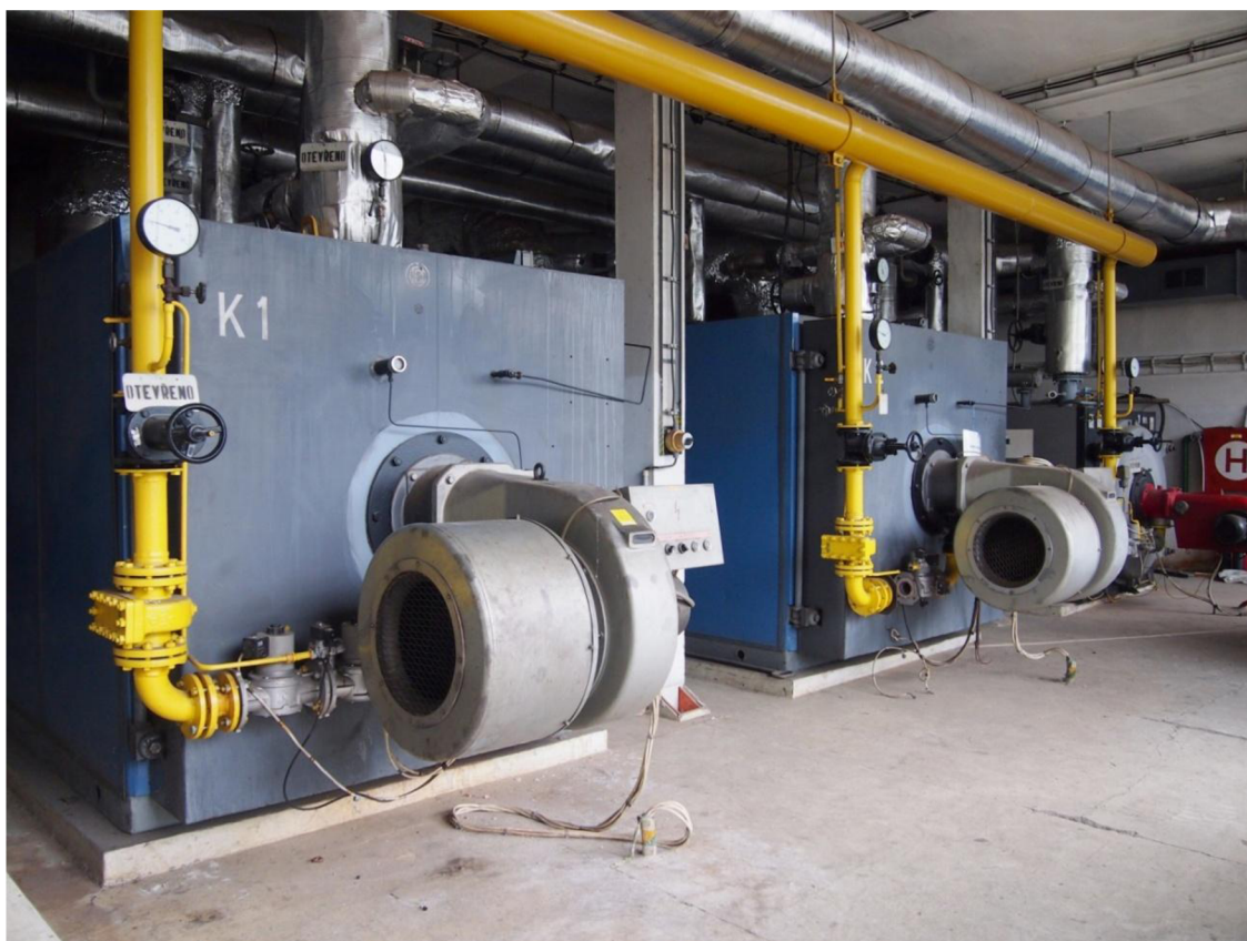
Obr. 6 Současná kotelna objektu [25]
