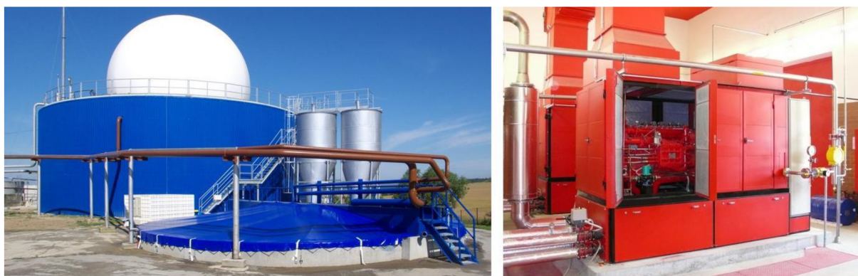
Obr. 3 Použití kogenerační jednotky v bioplynové stanici a na skládce odpadu [26]
