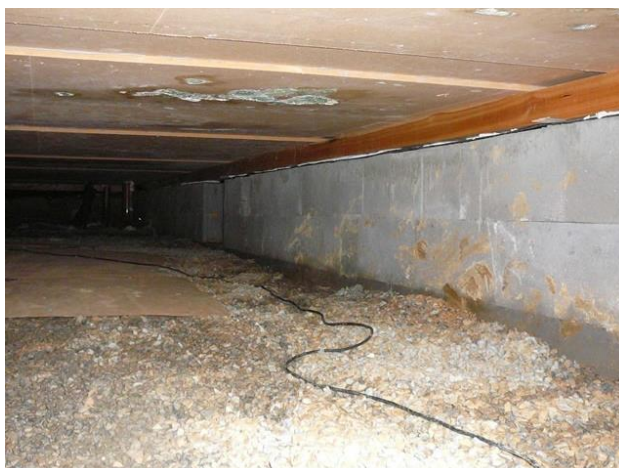
Obr. 6 Napadení podhledu plísněmi vlivem zvýšené vlhkosti v CS (Smola 2021)
