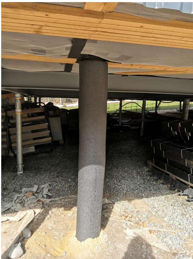
Příloha č. 8 Otevřená metoda CS, vstup kanalizace skrz podlahový rošt, obalen návlekovou izolací na bázi pěnového polyetylénu (vlastní foto)
