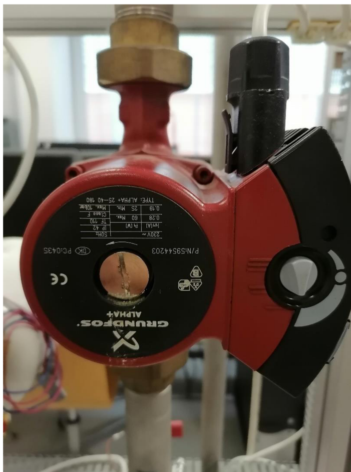
Obrázek 1.4 Čerpadlo pohánějící vodu ve stanici
