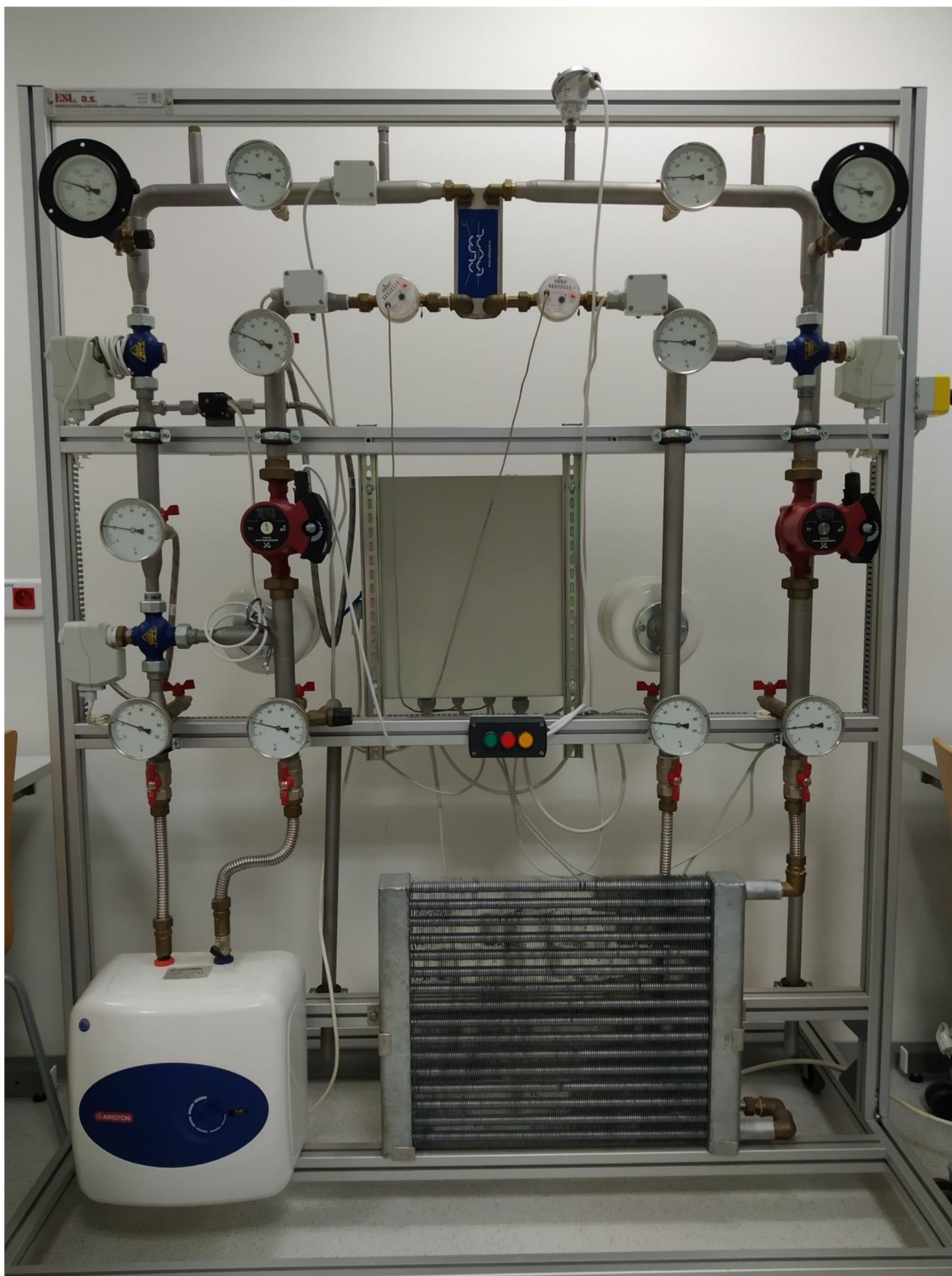
Obrázek 1.3 Měřící stanice s tepelným výměníkem
