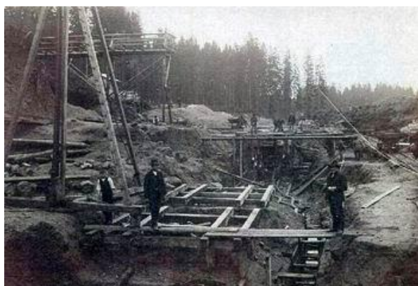
Obr. č. 11: Stavbu Protržené přehrady.
