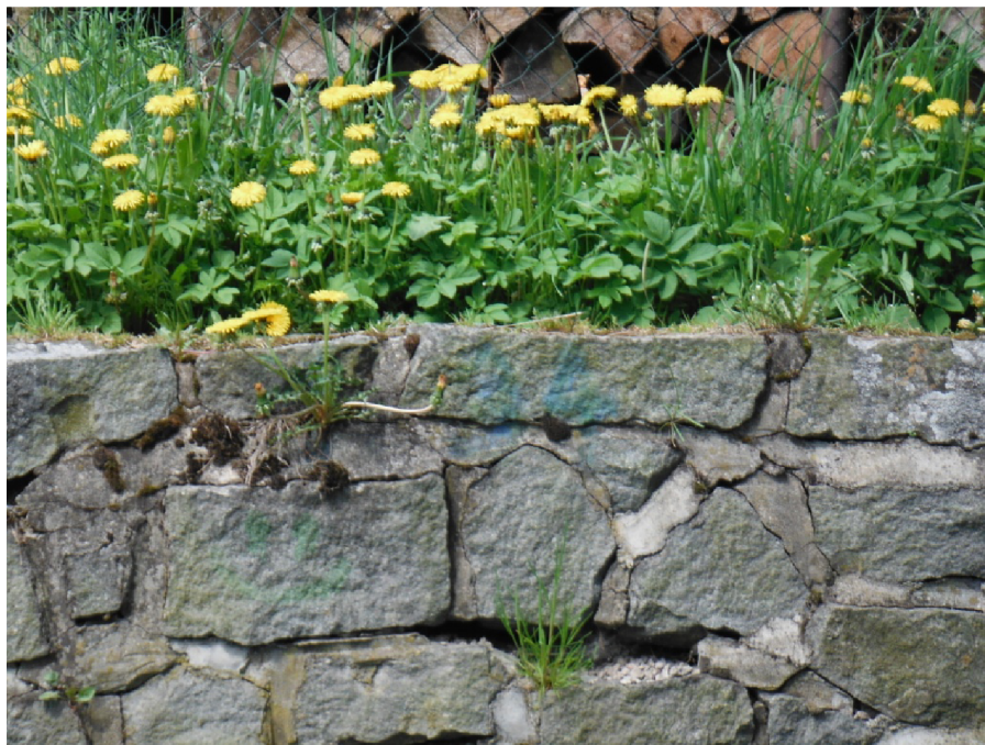
Obrázek 16: Rozpraskání zidky a prorůstání vegetace, rok 2015, ř. km 166,897
