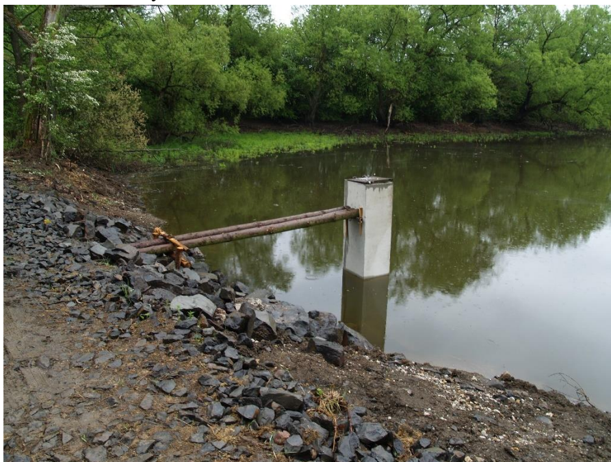
Obrázek č. 15 – Opravená spodní výpust, fotografie pořízena v červenci 2019 (Zdroj: Rybářství Mariánské Lázně s.r.o.)
