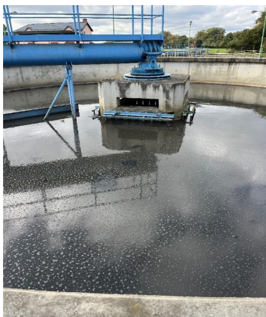
Obrázek 5: Usazovací nádrž ČOV Šternberk
