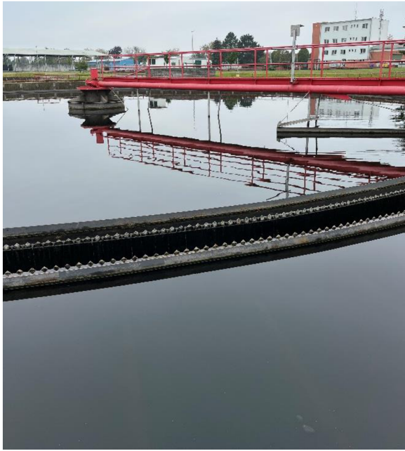
Obrázek 14: Dosazovací nádrž ČOV Olomouc Nové Sady
