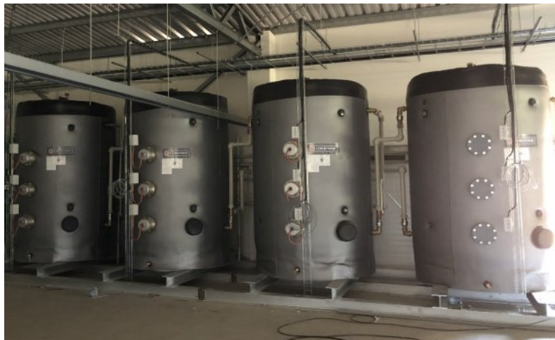
Obrázek 24 Akumulační zásobníky teplé vody v objektu na hovězí porážku [36]
