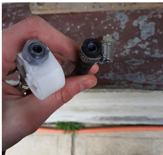
Obrázek 30: prasklá příruba průtokoměru
