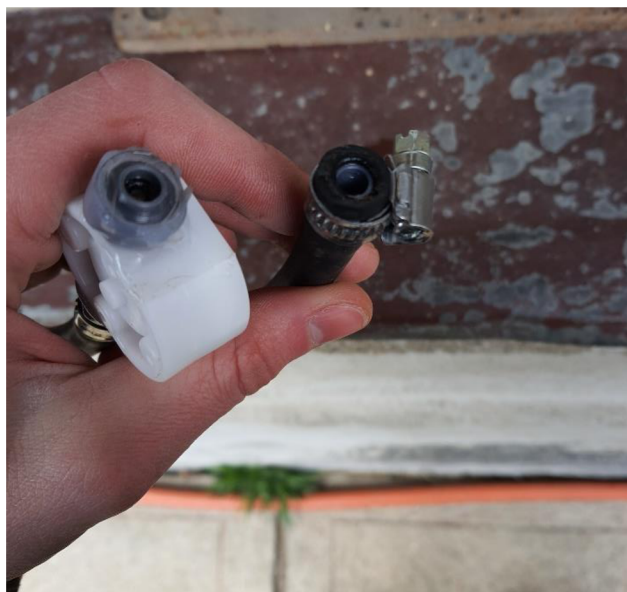
Obrázek 30: prasklá příruba průtokoměru
