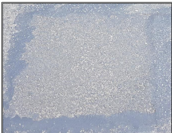
Obrázek č. 3: Vysprávka – po 1 roce, 27. 05. 2020
