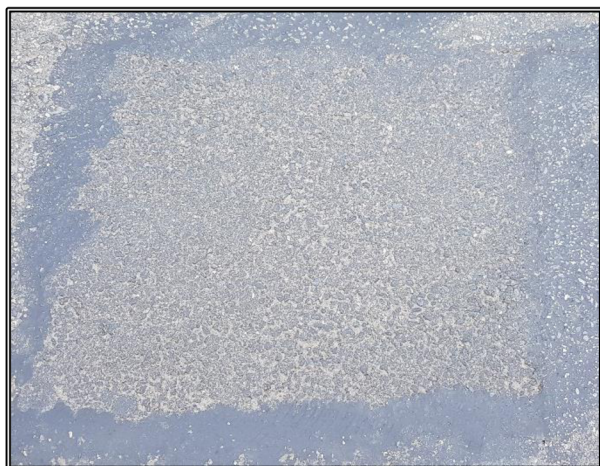
Obrázek č. 3: Vysprávka – po 1 roce, 27. 05. 2020
