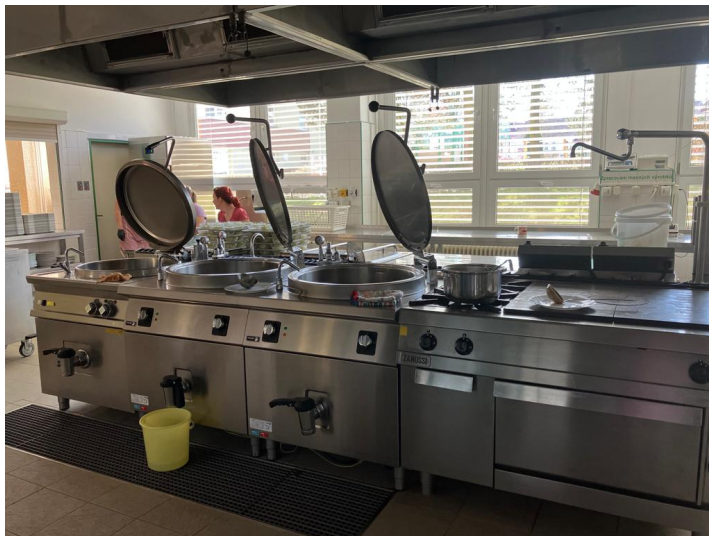
Příloha č. 7: Varné kotle ve školní jídelně Blatské sídliště
