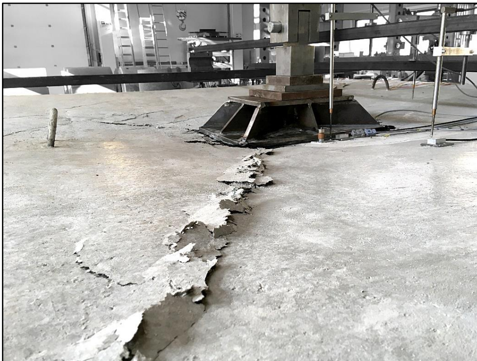
Obr. 117 Výrazná deformace desky z.GFRP.E.Ep.IV.N_2 s porušením horního povrchu diagonálním tlakovými trhlinami
