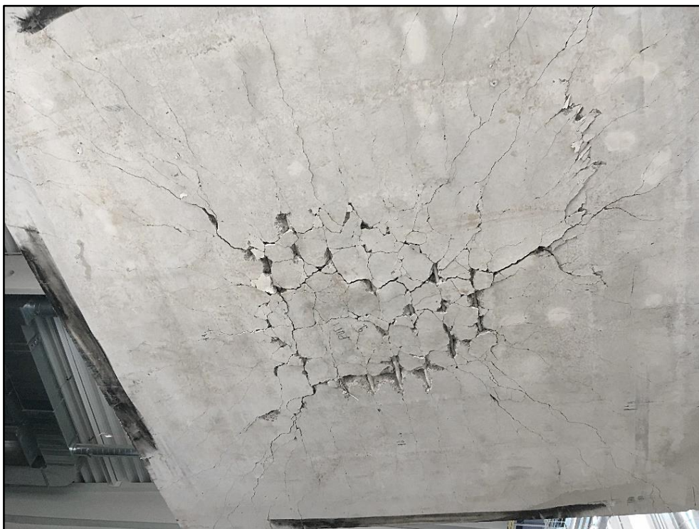
Obr. 110 Porušení spodního povrchu desky z.GFRP.E.Ep.IV.N_1 po monotónním zatěžování
