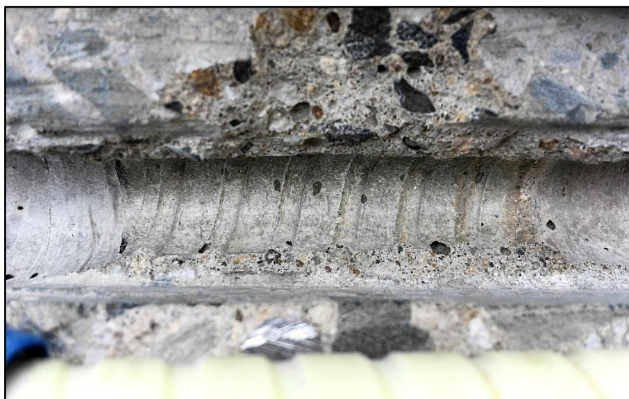
Obr. 48 Povrch betonu po únavové zkoušce – neporušený kontakt
