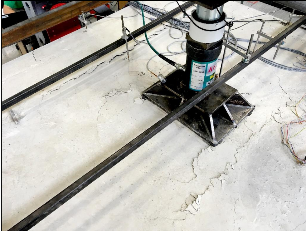
Obr. 102 Porušení horního povrchu vzorku z.GFRP.E.Ep.IV.N_3 po monotónním zatěžování v místě první a druhé řady kompozitních mřížek a následným ztlačením zatěžovací desky
