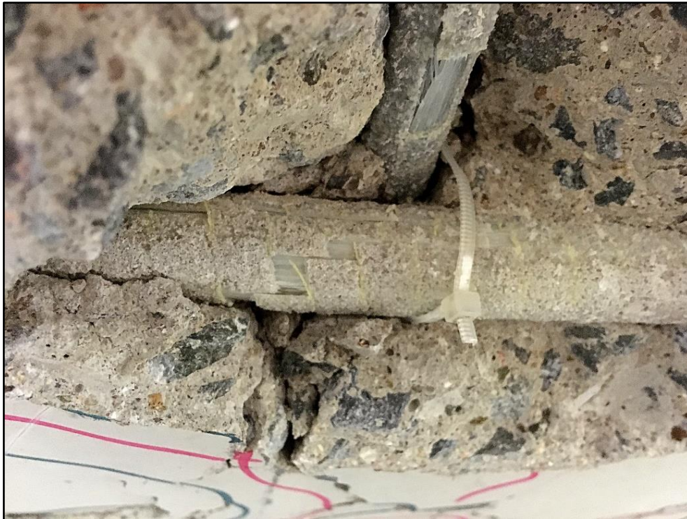
Obr. 104 Porušení prutu průměru 18 mm v hlavním směru desky a prutu průměru 14 mm ve vedlejším směru
