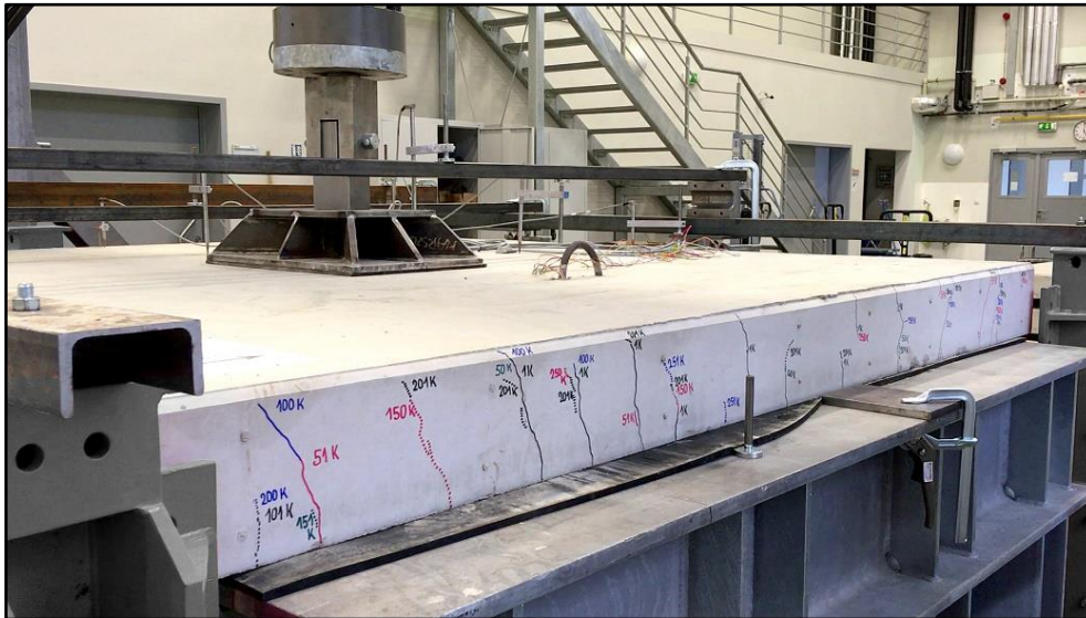
Obr. 100 Čelní strana desky z.GFRP.E.Ep.IV.N_3 se zvýrazněnými trhlinami po únavovém zatěžování
