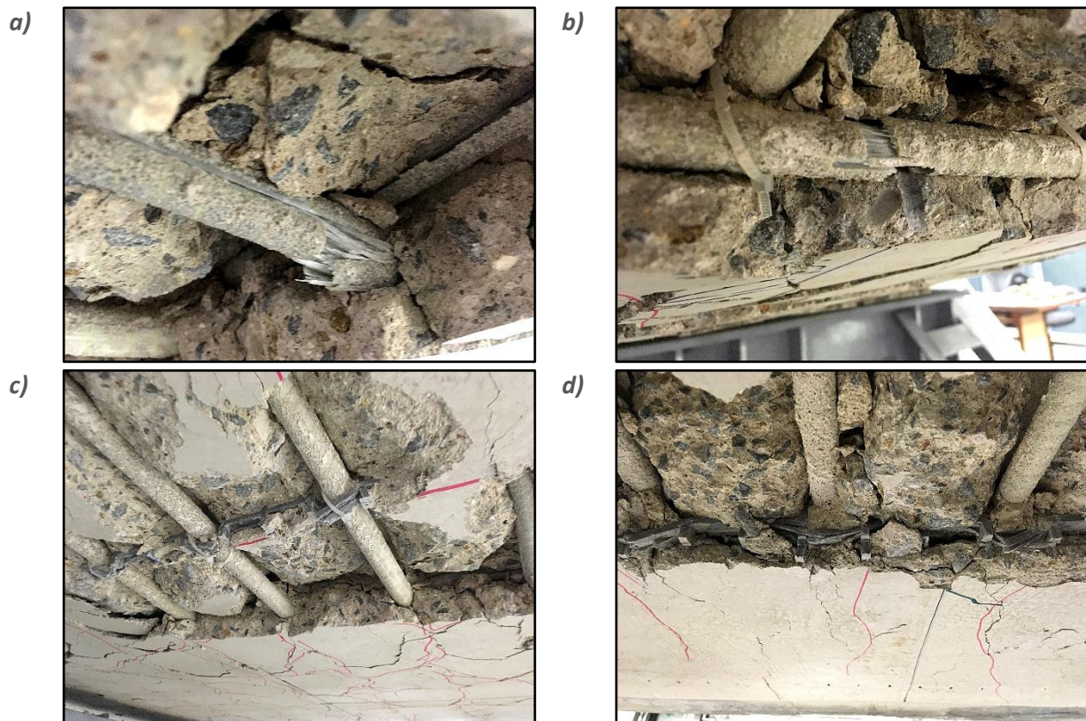
Obr. 96 Porušení prutů a kompozitní mřížky po monotónním zatížení vzorku z.GFRP.E.Ep.IV.N_4: a) a b) porušení prutu profilu 14 mm; c) porušení kompozitní mřížky pod pruty hlavní vrstvy výztuže; d) porušení kompozitní mřížky pod sekundární vrstvou výztuže
