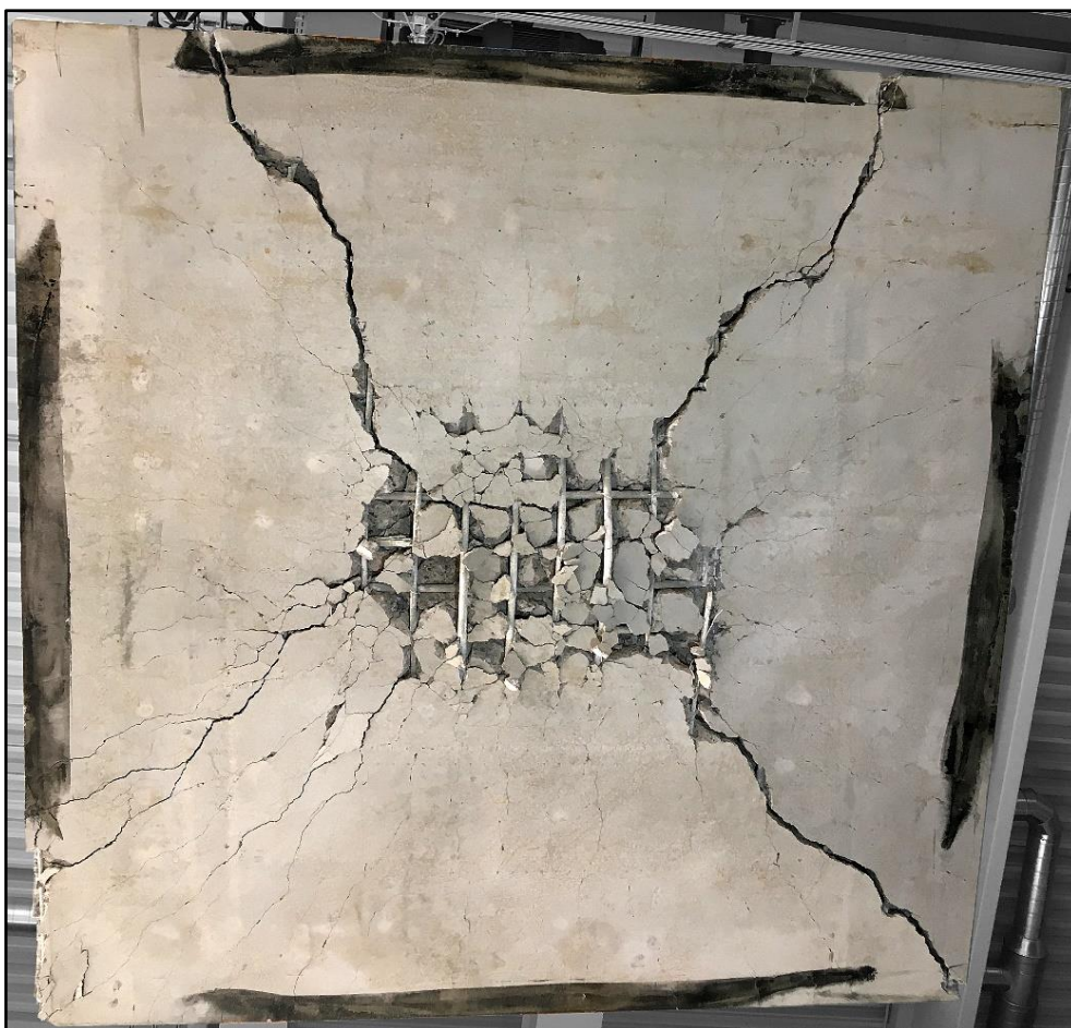
Obr. 118 Porušení spodního povrchu desky z.GFRP.E.Ep.IV.N_2 po monotónním zatěžování
