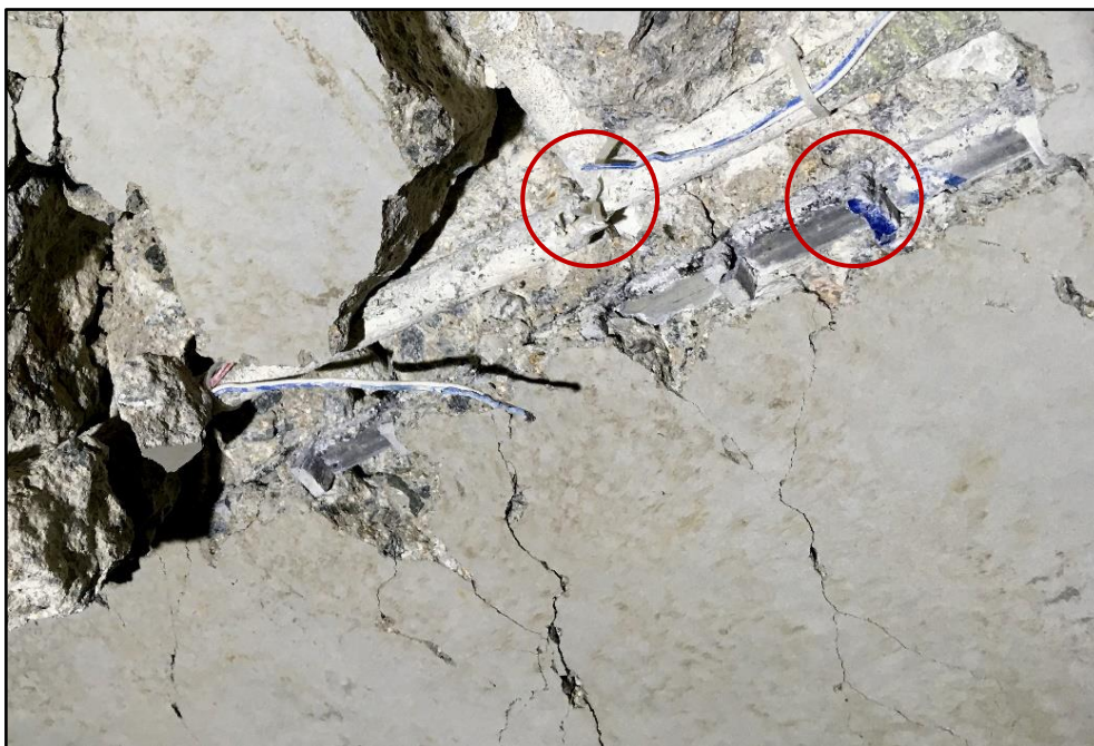
Obr. 114 Porušení prutu a kompozitní mřížky po únavovém zatěžování desky z.GFRP.E.Ep.IV.N_2
