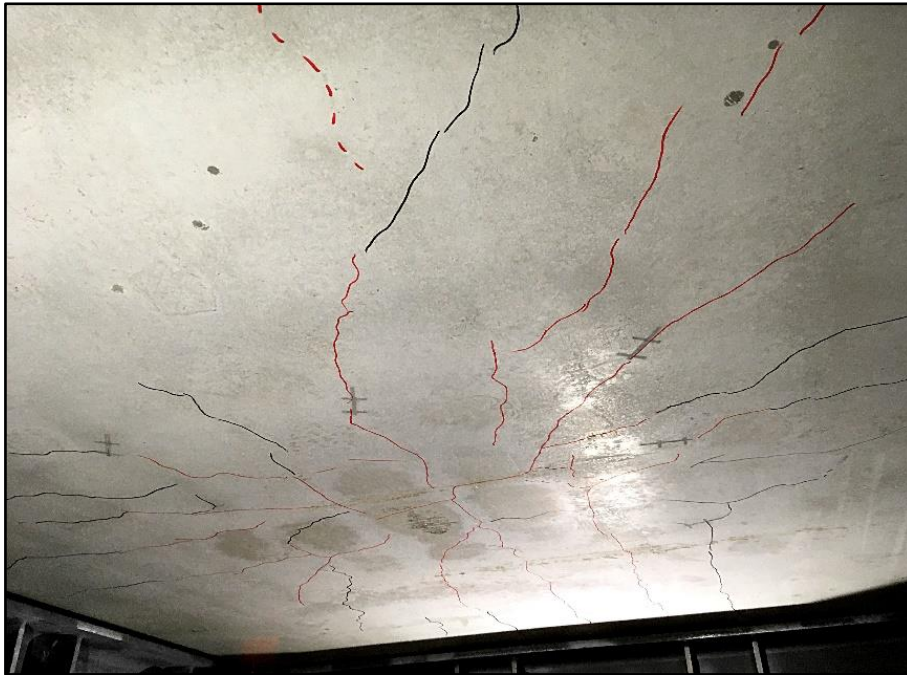
Obr. 84 Spodní povrch vzorku z.ocel_1 po první fázi zatěžování se zvýrazněnými trhlinami
