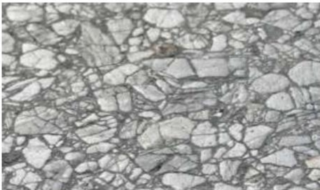
Obr. 15: Ztráta mikrotextury u vozovky s netuhým krytem [5]
