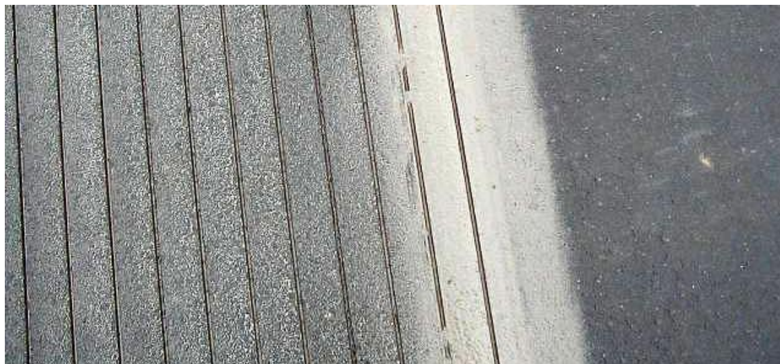
Obr. 33: Textura vozovky po a před drážkováním [22]
