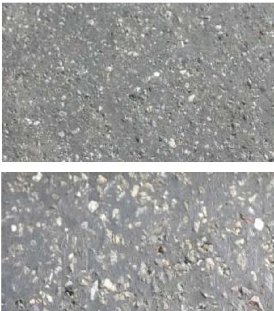
Obr. 17: Ztráta makrotextury vozovky s netuhým krytem [5]
