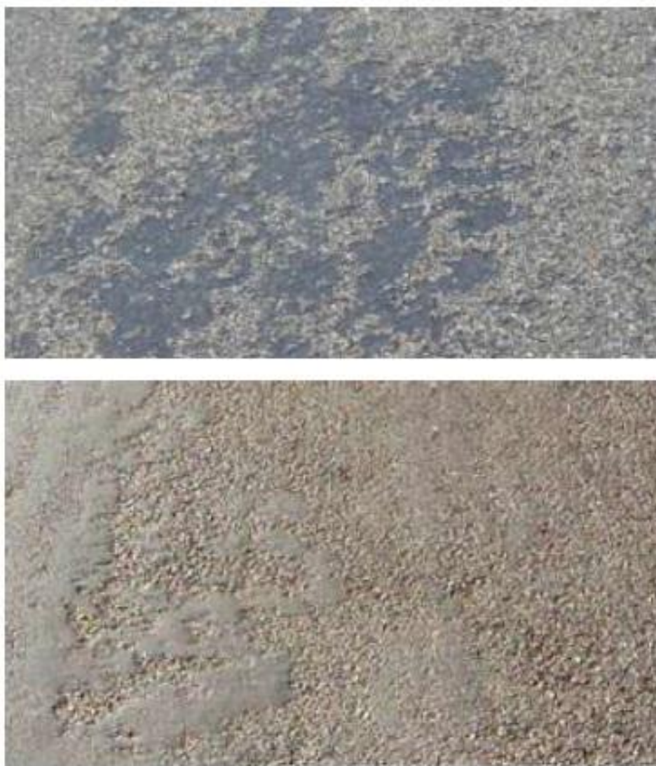
Obr. 18: Ztráta kameniva z nátěru vozovky s netuhým krytem [5]
