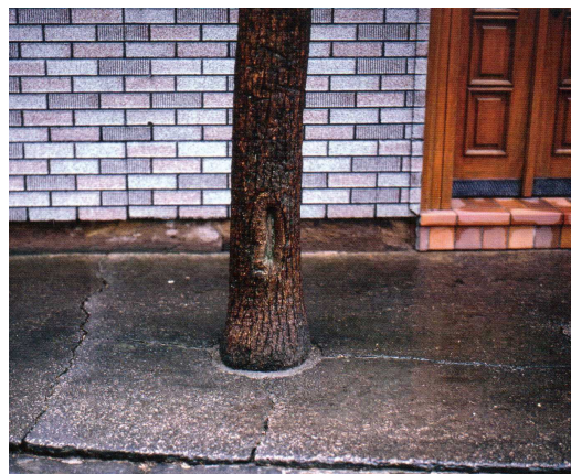
Obr. 6: Špatná výsadba – nepoužití ochranné mříže s dostatečným prostorem pro růst kmene (Roloff, 2016)
