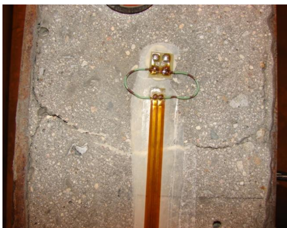
Obr. E.33 Výsušné trhliny, které byly evidovány pouze u betonu třídy C70/85
