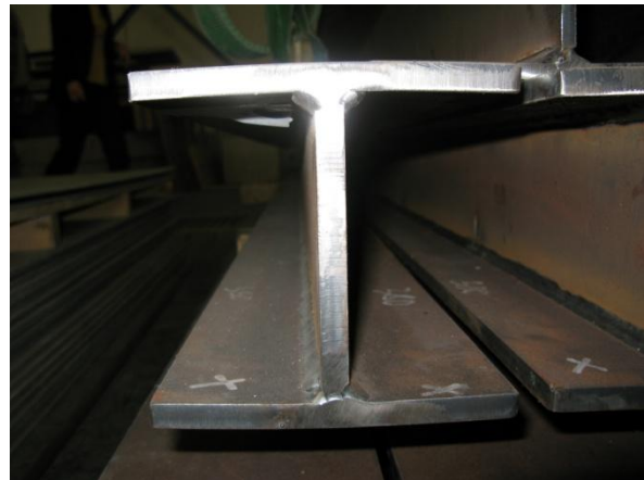
Obr. E.6 Deformace pásnic svařovaných sloupů H 160
