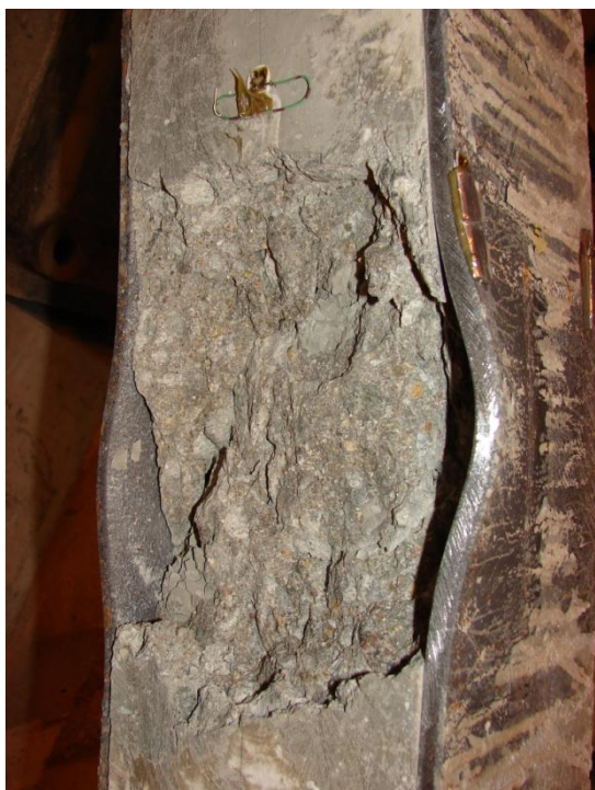
Obr. E.41 Tlakové porušení betonu doprovázené odstřelením části betonu
