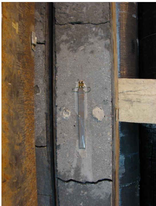
Obr. E.47 Tahové porušení betonu ovlivněné výsušnými trhlinami
