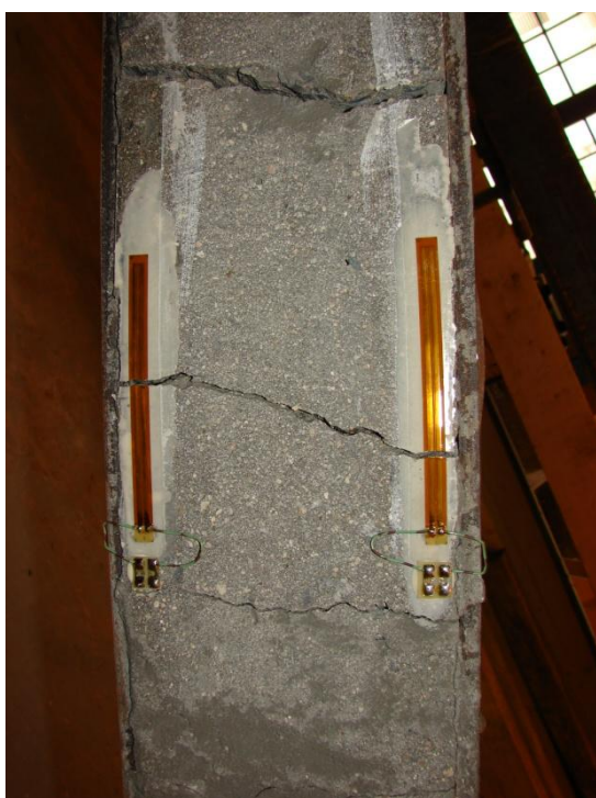
Obr. E.37 Tahové porušení betonu tělesa H6
