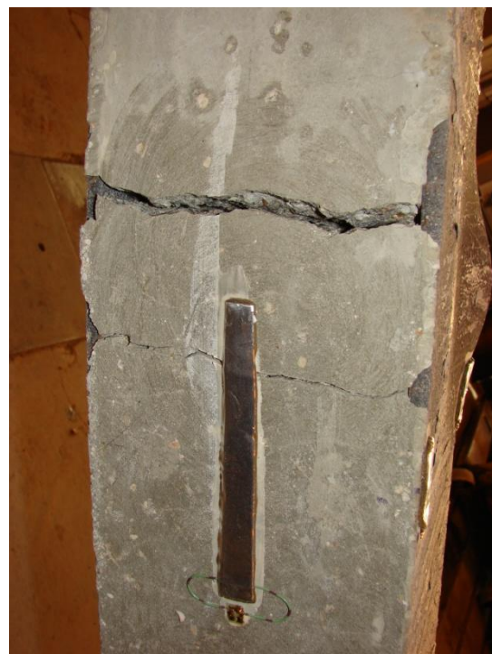
Obr. E.42 Tahové porušení betonové části průřezu
