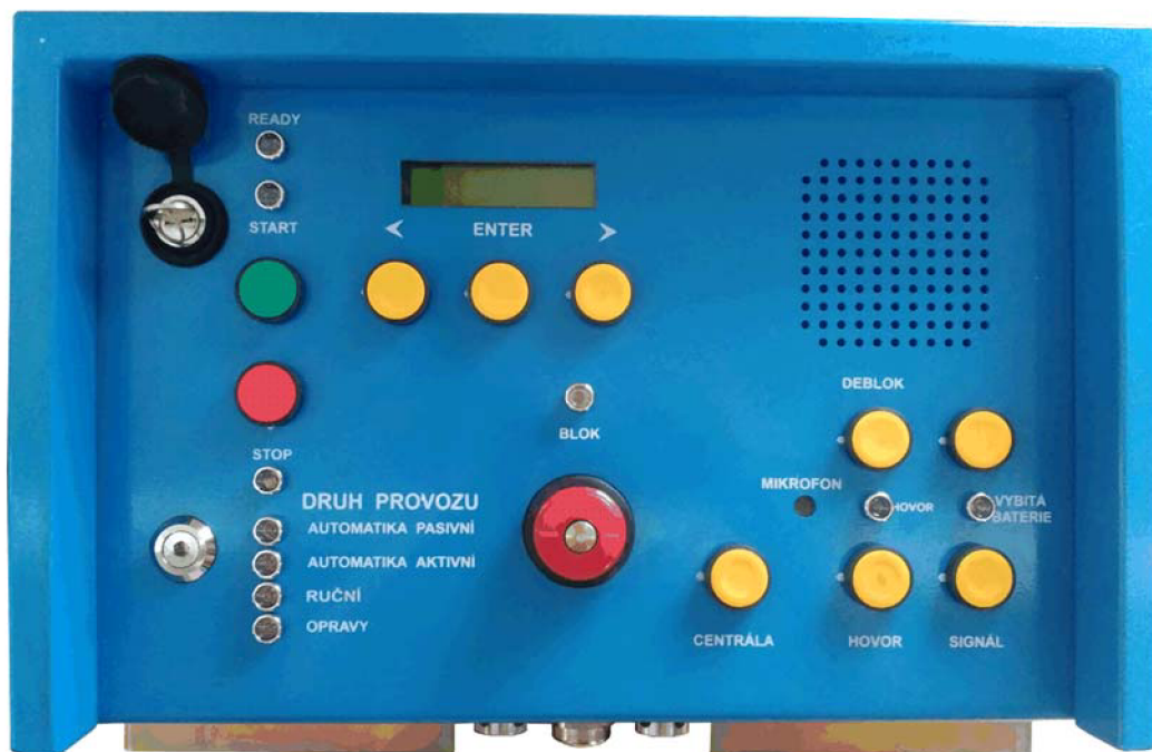
Obrázek 1.1: Stanice dopravníku SD1
