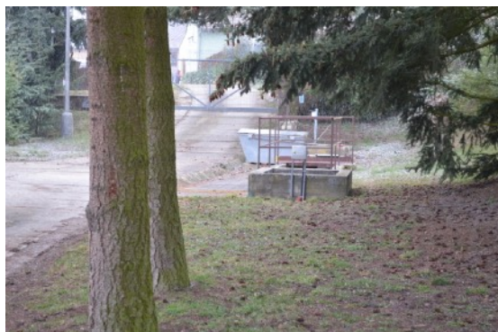
obr. 23, ČOV Erpužice (foto autor 2021)
