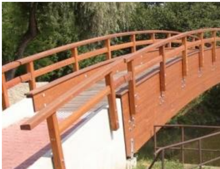
Obr. 33 Oblouková lávka - mezi sloupky a nosníkem je distanční mezera, madlo zábradlí je zkoseno, hlavní nosníky jsou kryté deskou ( http://www.konstrukce-tesko.cz/ )
