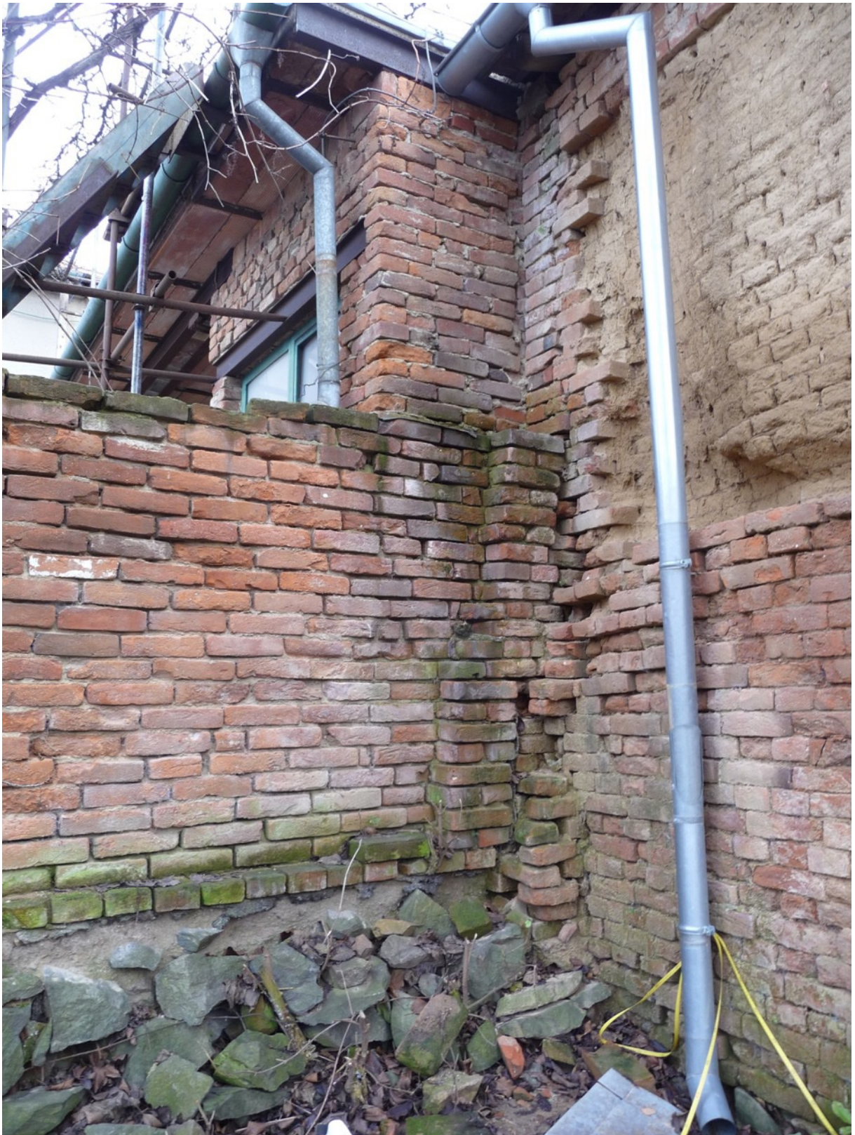
Obr. č. 13 – dvorní přístavek s viditelnými konstrukčními a statickými poruchami. Je svým technickým stavem nerekonstruovatelný (Vlastní zpracování, 2023)
