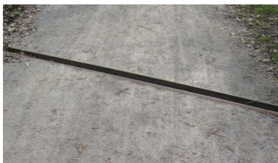
Obr.č. 45: Odvodňovací svodnice
