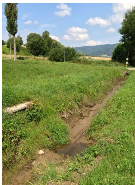
Fotografie č. 9 – Částečně zanešený odvodňovací příkop (foto 08/2014: D.Patócs)
