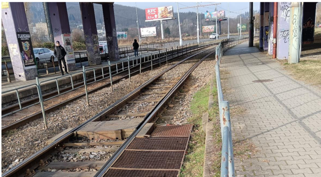
Obrázek 12: Splítková výhybka Vozovna Komín [13]
