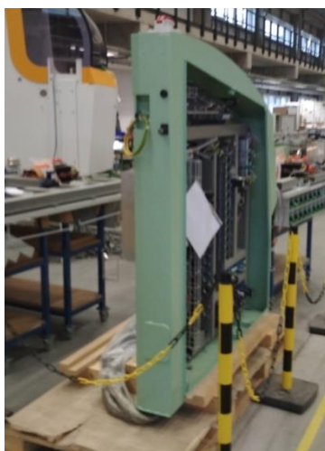
Obr. 14 hotový a odzkoušený rozvaděč (zdroj: vlastní)
