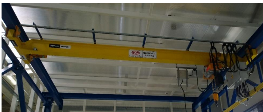
Obr. 17 mostový jeřáb (zdroj: [18])
