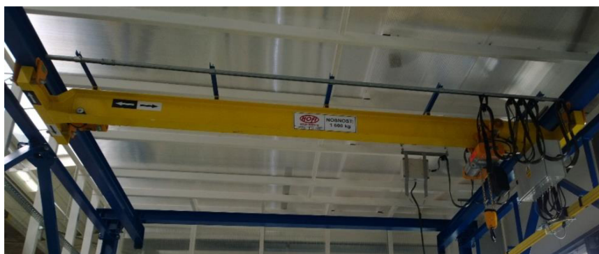
Obr. 17 mostový jeřáb (zdroj: [18])
