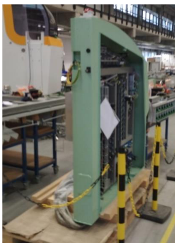
Obr. 14 hotový a odzkoušený rozvaděč (zdroj: vlastní)
