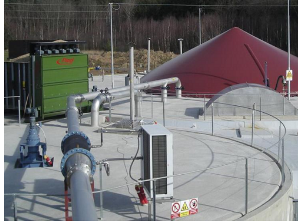
Obrázek 4.10: Plynová trasa a další technologické prvky BPS ve Vejprnicích [17]
