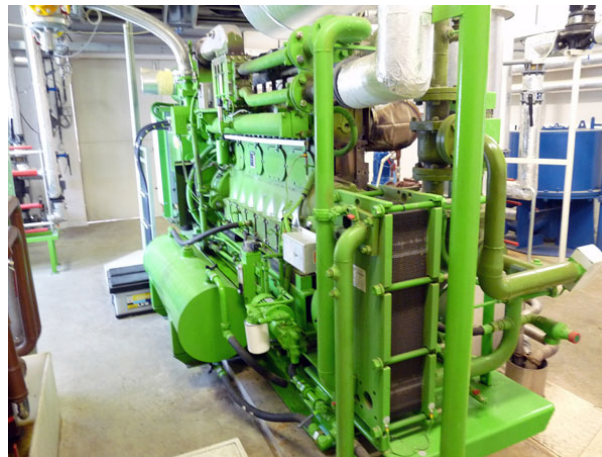
Obrázek 4.11: Kogenerační jednotka s el. výkonem 330 kW BPS Kněžnice [18]
