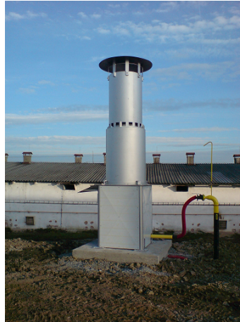
Obrázek 4.12: Hořák pro spalování zbytkového bioplynu BPS-Kralovice [16]
