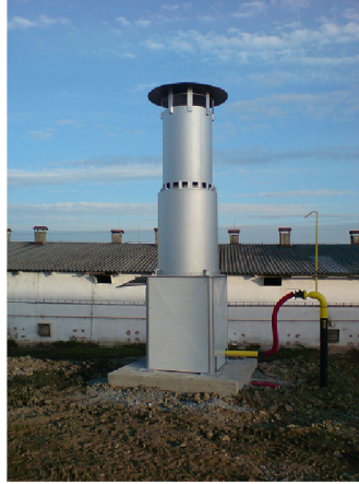
Obrázek 4.12: Hořák pro spalování zbytkového bioplynu BPS-Kralovice [16]
