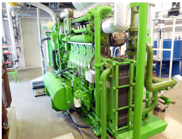
Obrázek 4.11: Kogenerační jednotka s el. výkonem 330 kW BPS Kněžnice [18]
