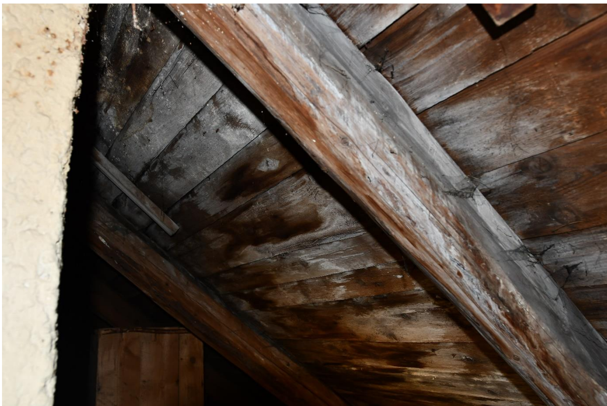
Obrázek 6: Poškození KM 3 - detail na KR 10
