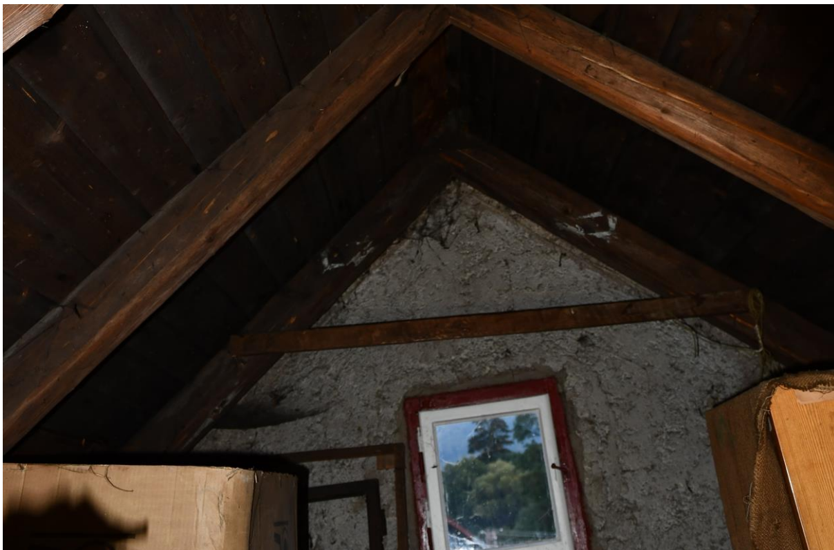
Obrázek 17: Poškození KM 1 - celkový pohled na vazbu poškozených kroků KR 1
