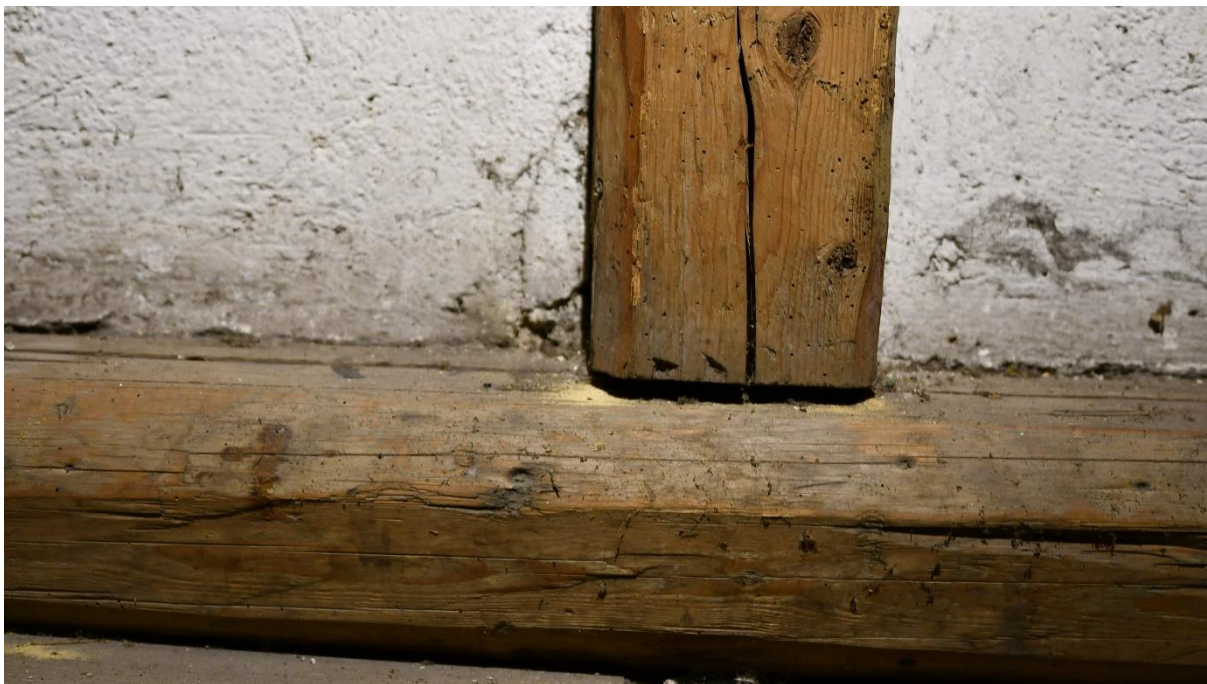
Obrázek 18: Poškození KM 4 - poškozená spodní část sloupu Červotočem proužkováním ( Anobium punctatum )
