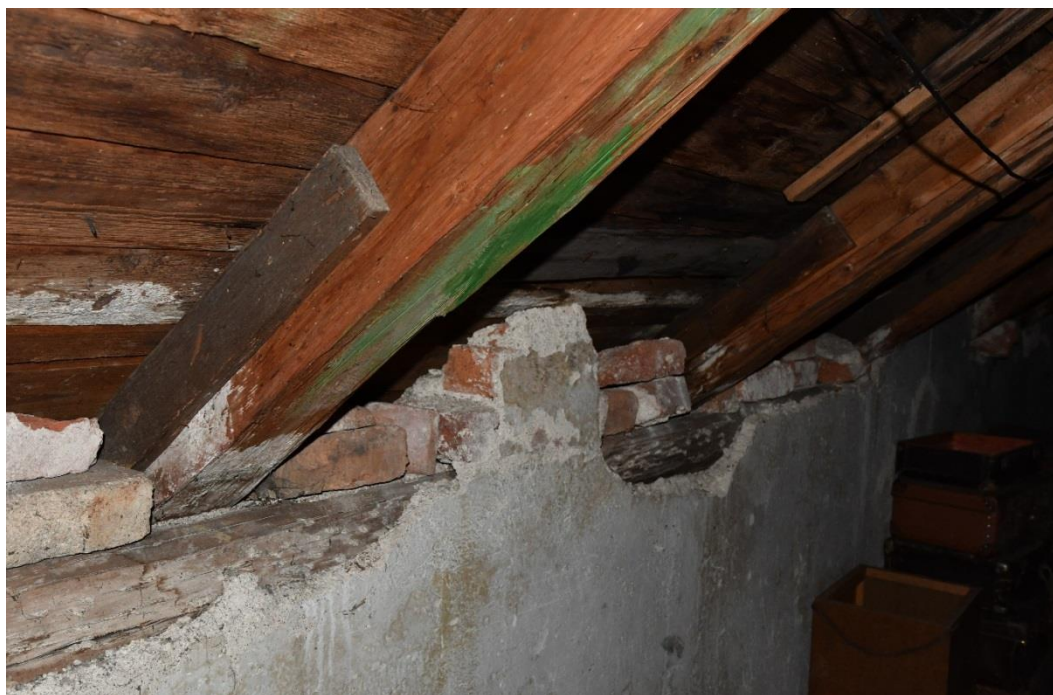
Obrázek 10: Poškození KM 2 - krokve KR 13 - 15 poškozené stupněm 3 - 4
