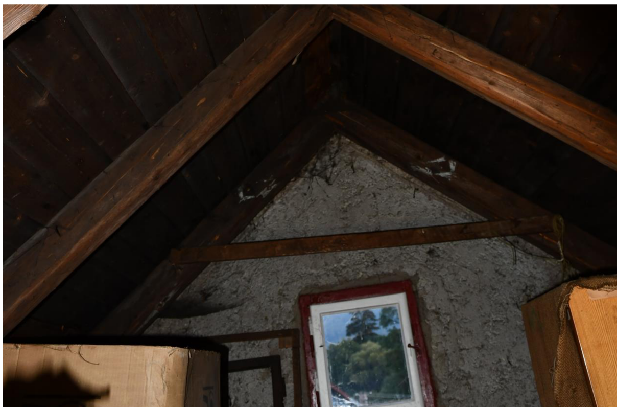
Obrázek 17: Poškození KM 1 - celkový pohled na vazbu poškozených krokví KR 1
