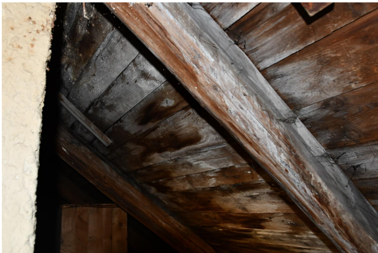
Obrázek 6: Poškození KM 3 - detail na KR 10
