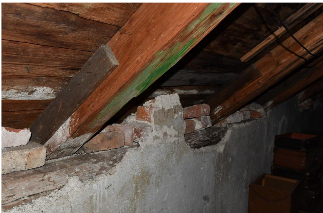
Obrázek 10: Poškození KM 2 - krokve KR 13 - 15 poškozené stupněm 3 - 4
