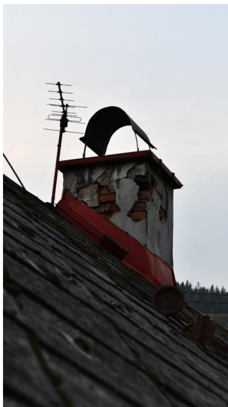
Obrázek 13: Poškozená nadstřešní část komínového tělesa (Vlastní tvorba)
