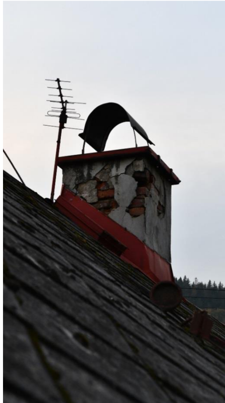
Obrázek 13: Poškozená nadstřešní část komínového tělesa (Vlastní tvorba)
