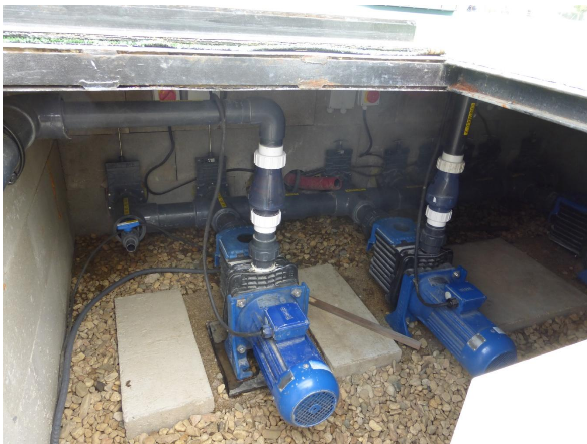
Obrázek č. 6: Čerpací stanice na přírodním koupališti Brno-jih
