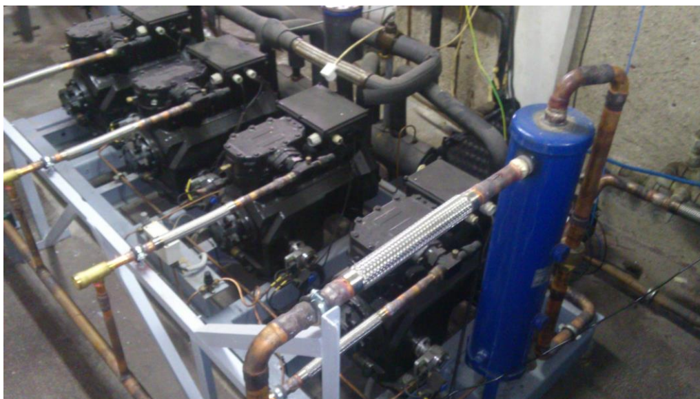
Obr. 32 Měřené zařízení 1 – kompresorová jednotka
