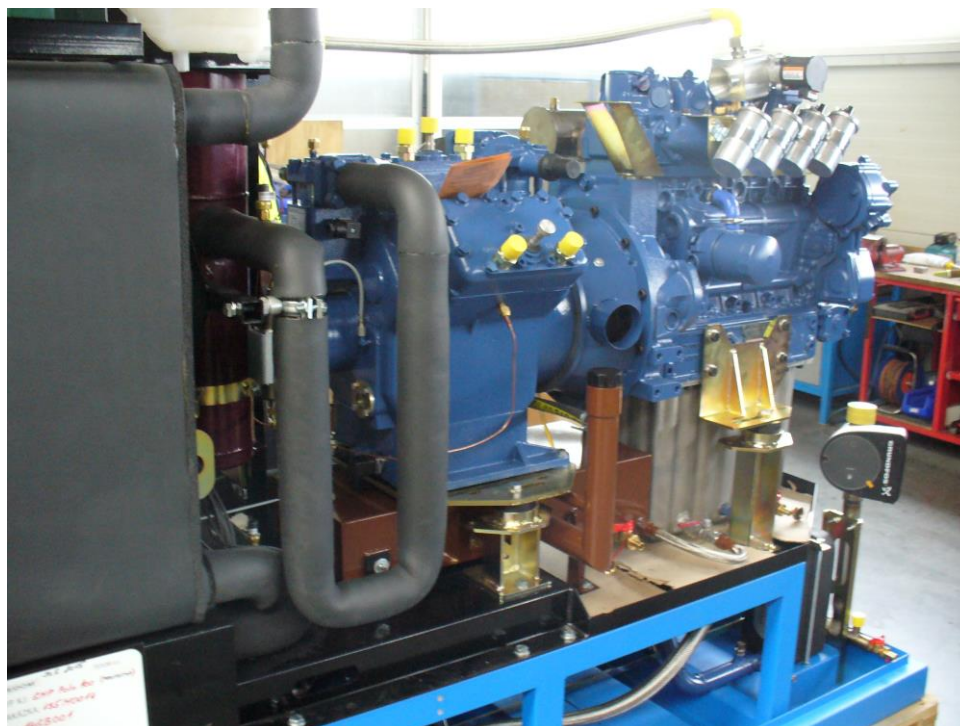
Obr. 35 Měřené zařízení 2 - Plynové tepelné čerpadlo GHP Polo 100
