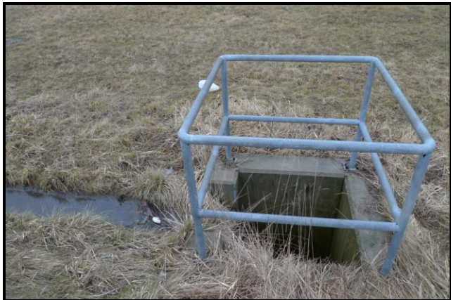
OBRÁZEK Č. 24: SVOD DEŠŤOVÉ VODY DO VODOTEČE
