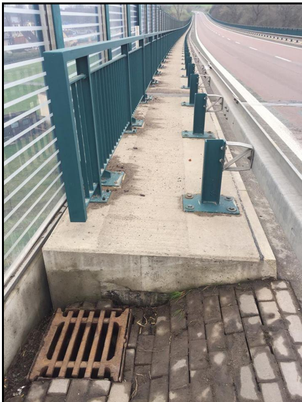
OBRÁZEK Č. 16: SVOD DEŠŤOVÉ VODY DO VODOTEČE
