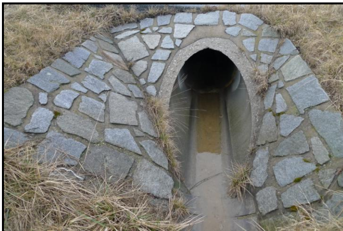
OBRÁZEK Č. 15: SVOD DEŠŤOVÉ VODY DO VODOTEČE
