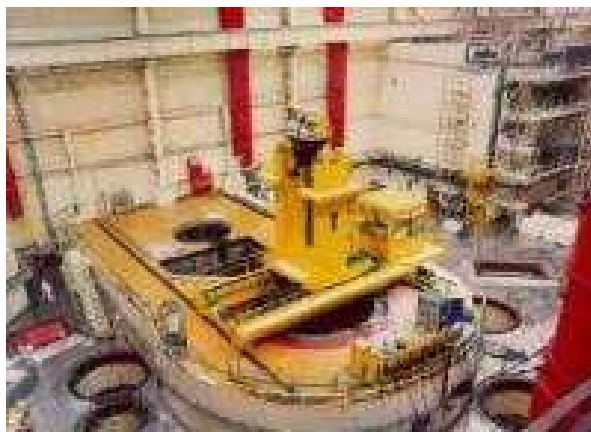
Obr. č. 5: Bazén s vyhořelým jaderným palivem, Dukovany (Zdroj: SURAO)
