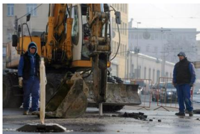
Obr. 31 Havárie vodovodu (zdroj: http://www.ceskenoviny.cz/zpravy/havarie-vodovodu-komplikovala-dopravu-v-prazskych-vysocanech/754788 )
