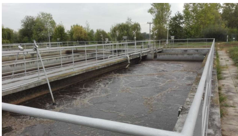
Obrázek č. 15: Nitrifikace 1 a 2 – Polyvalentní nádrže
