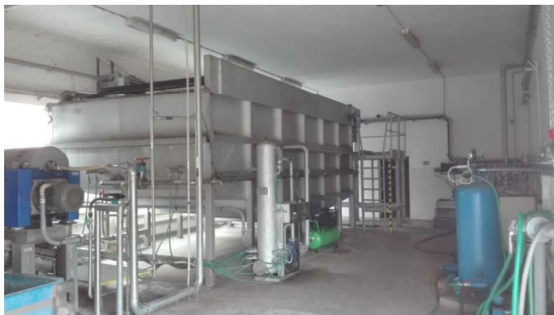
Obrázek č. 22: Flotační jednotka k zahušťování kalu
