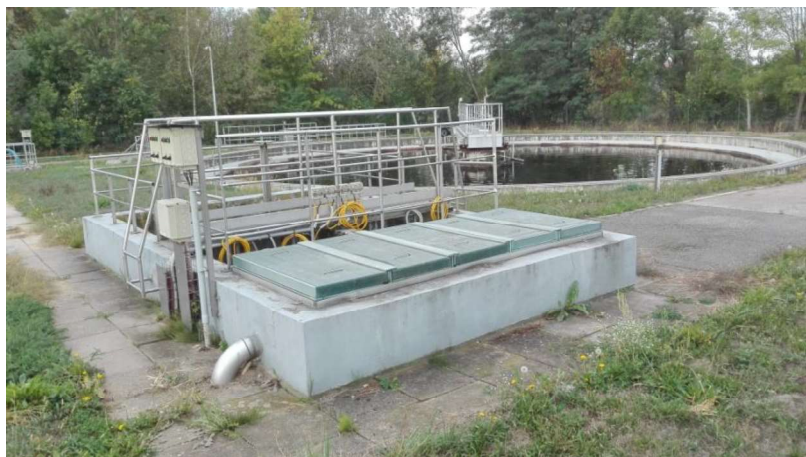
Obrázek č. 19: Rozdělující a recirkulační jímka
