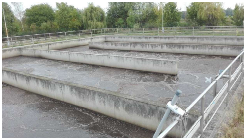
Obrázek č. 16: Nitrifikace 1 a 2 – Polyvalentní nádrže
