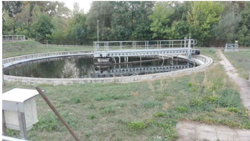
Obrázek č. 18: Dosazovací nádrž – zde dochází k separaci kalu
