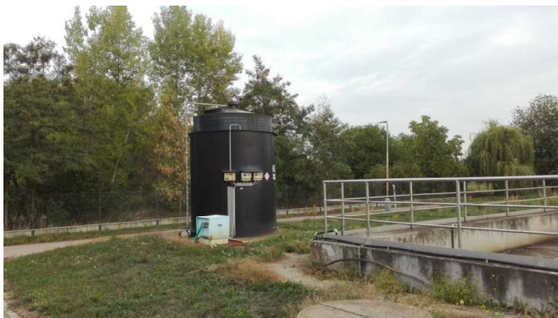
Obrázek č. 17: Dávkovací souprava síranu železitého (Fe 2 (SO 4 ) 3 )
