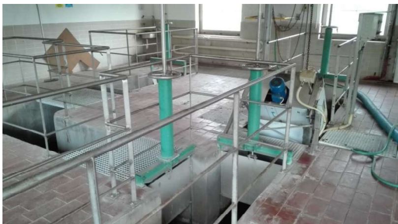
Obrázek č. 10: Strojně stírané česle, česlicový kanál s obtokem a ruční stavítka na obtokových žlabech
