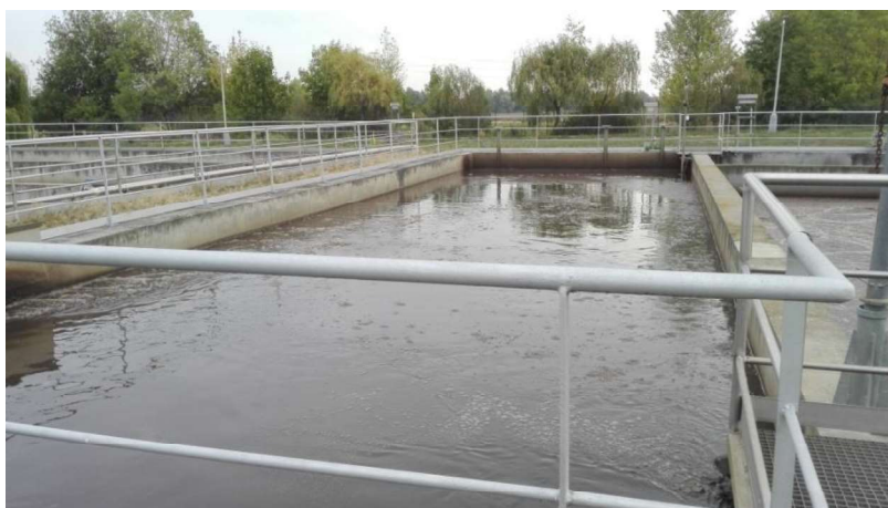
Obrázek č. 14: Denitrifikační nádrž
