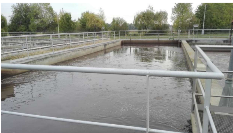
Obrázek č. 14: Denitrifikační nádrž
