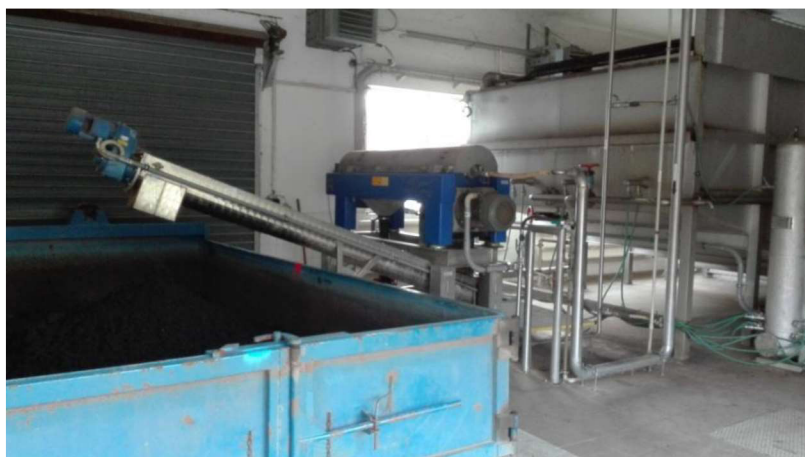
Obrázek č. 24: Odvodnění kalu (strojní) – odstředivka ALDEC 30 a kontejner na odvodněný kal
