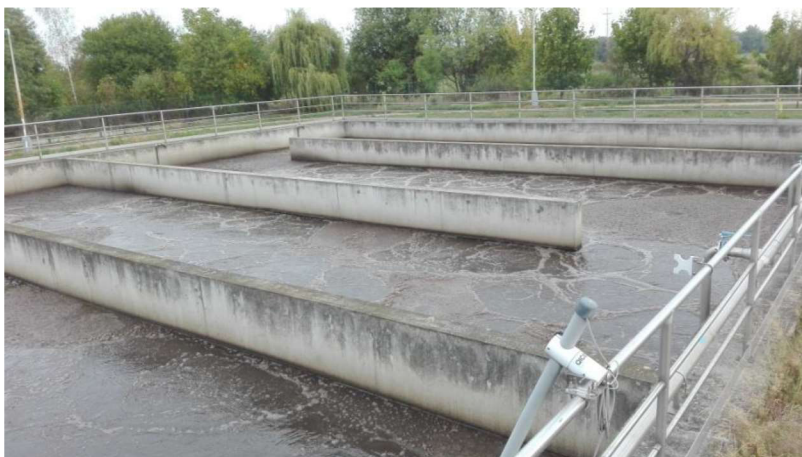
Obrázek č. 16: Nitrifikace 1 a 2 – Polyvalentní nádrže
