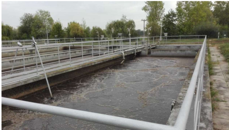
Obrázek č. 15: Nitrifikace 1 a 2 – Polyvalentní nádrže
