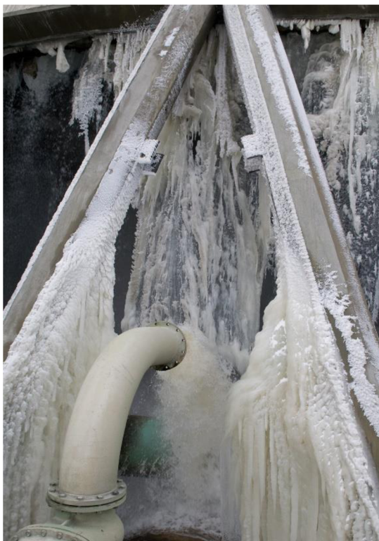
Obr. 9.6: Zamrzání chladicí věže [12]
