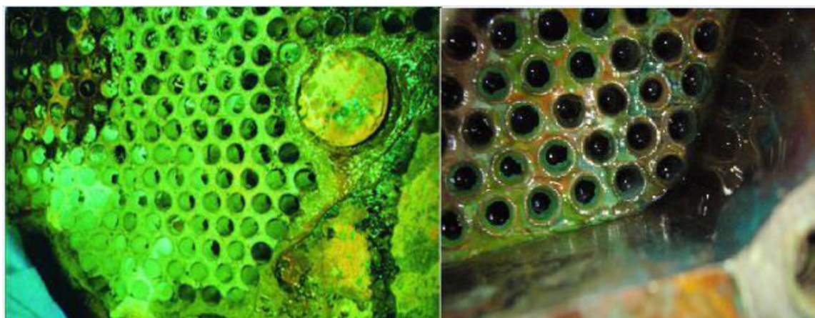
Obr. 15: Ukázka biologického zanášení na stěnách výměníku[25]
