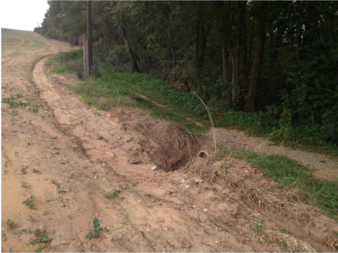
Obr. č. 9: Odtok vody z pole do strže, 10.10.2013
