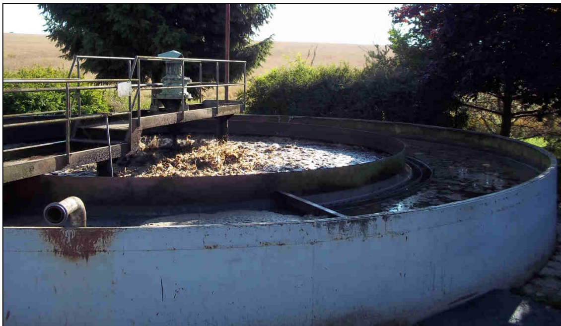
Obr. 4.10: ČOV Rudice - zařízení Kovoblok.
