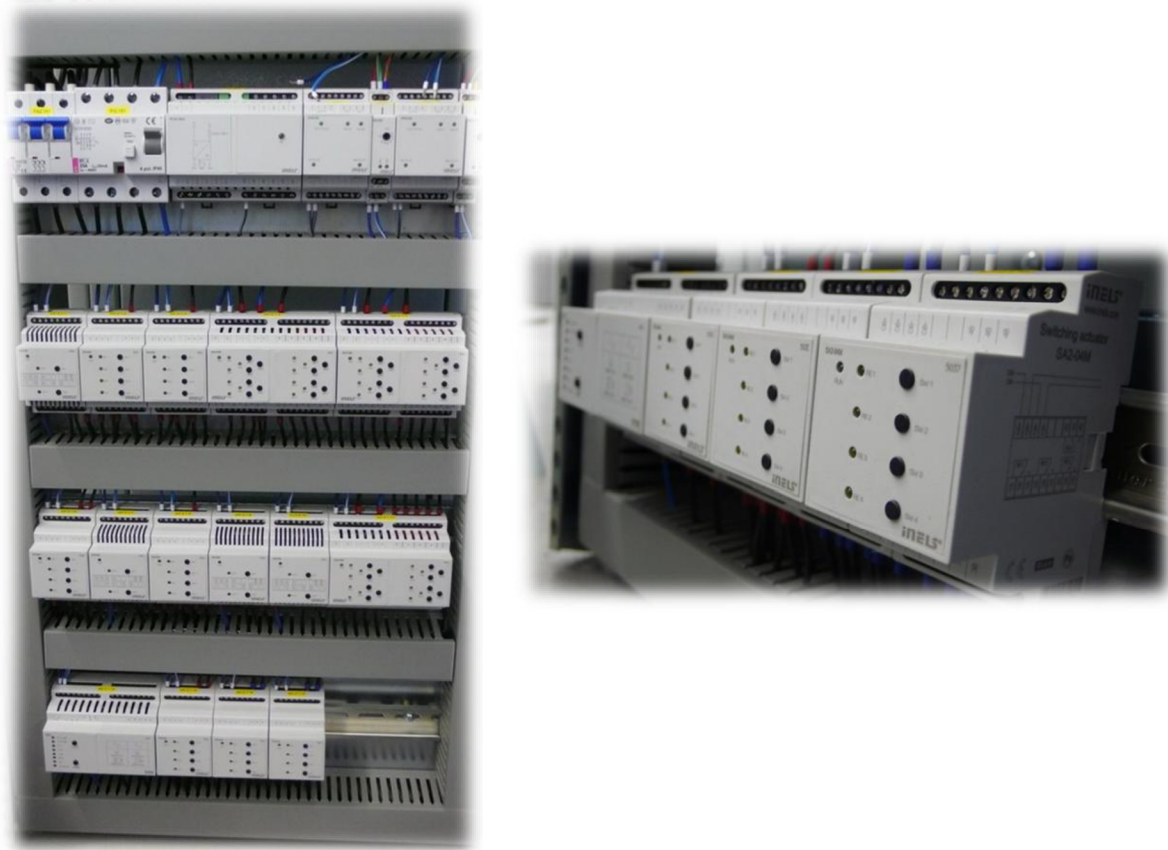
Obr. 5-2 Pohled do rozváděče RP2.0
